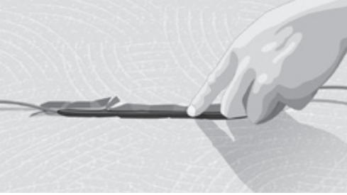
Kuva 2. Kylmä- ja lämmityskaapelin liitosura
